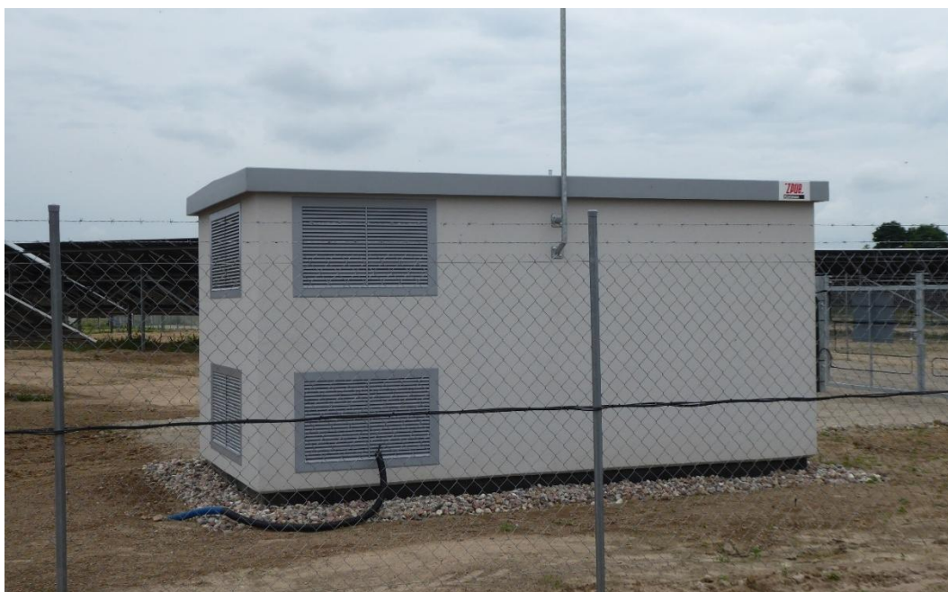
Fotografia 18 Stacja transformatorowa kontenerowa
