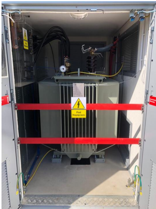
Fotografia 19 Stacja transformatorowa z misą do wycieku oleju (źródło: fotografia własna)
