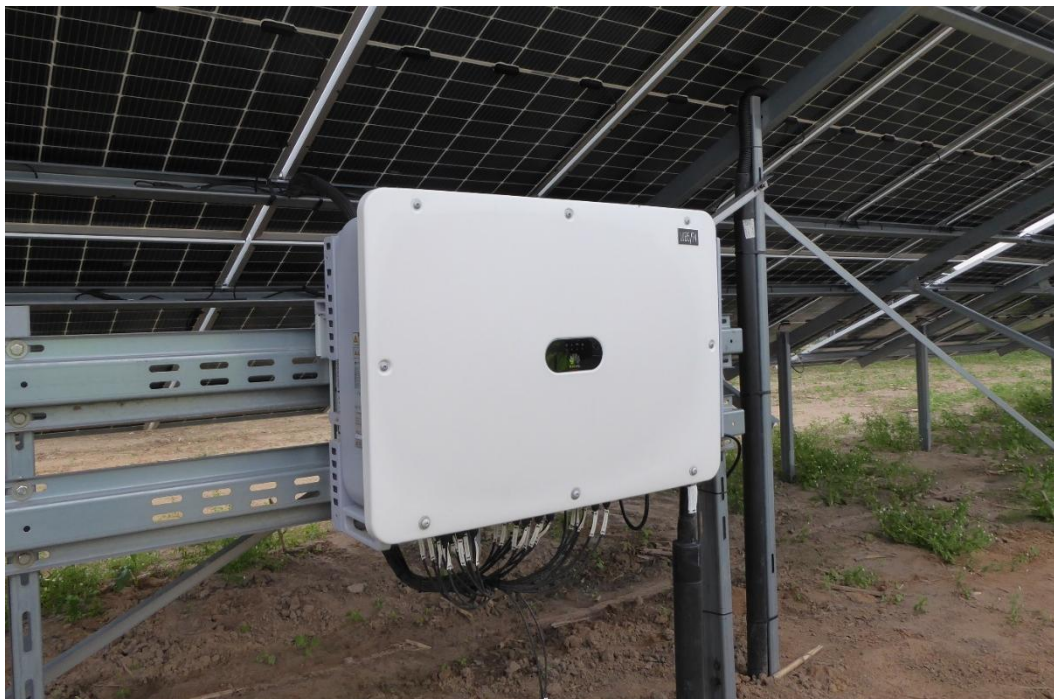
Fotografia 17 Przykład inwertera rozproszonego zamontowanego pod panelami (źródło: zdjęcie własne)
