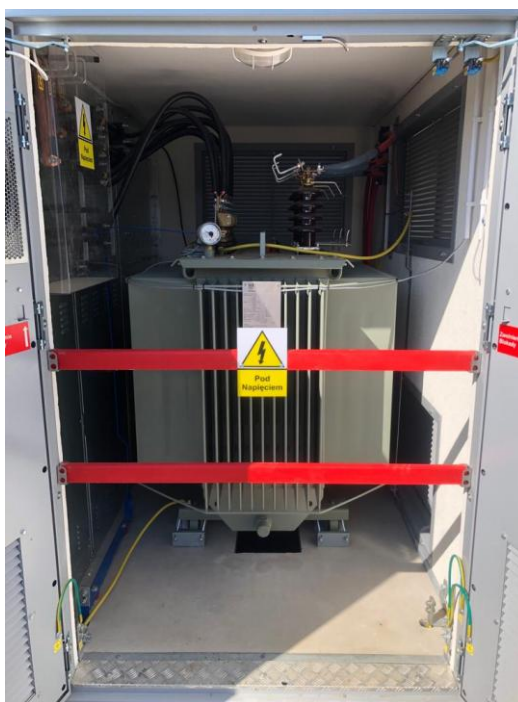
Fotografia 4 Stacja transformatorowa z misą do wycieku oleju (źródło: fotografia własna)
