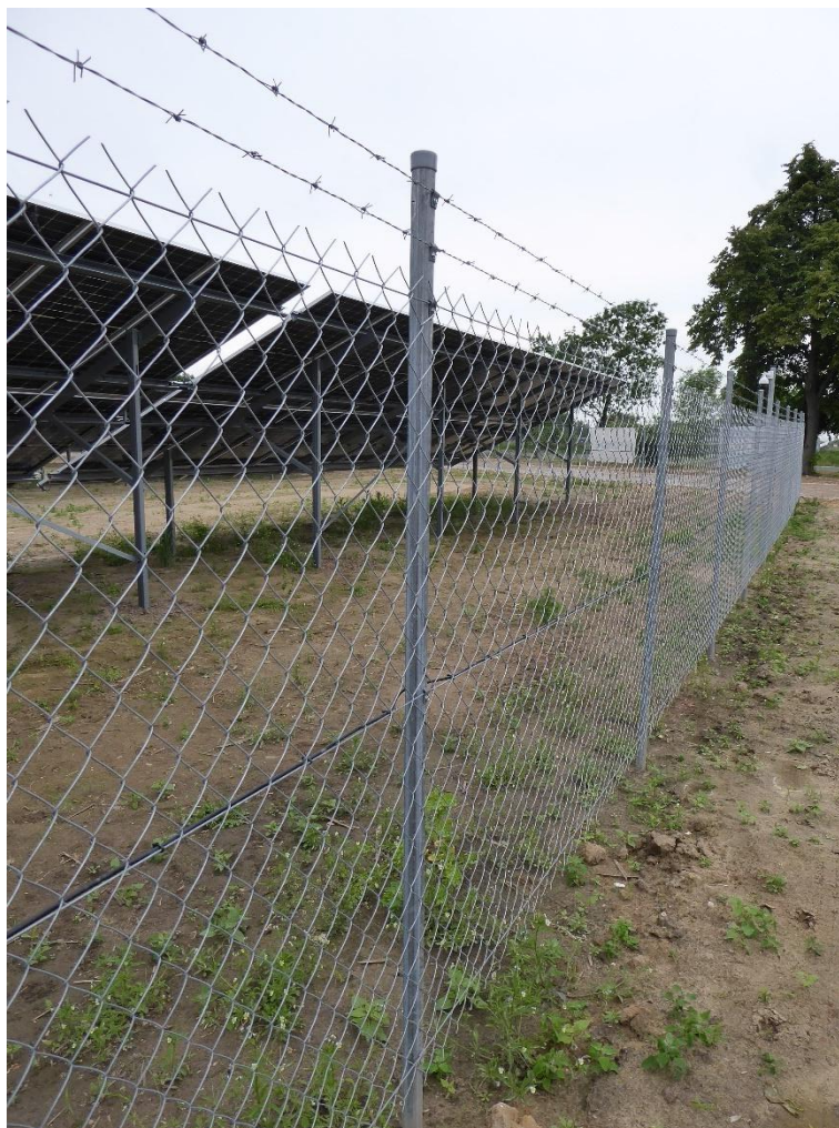
Fotografia 6 Ogrodzenie przedsięwzięcia – bez podmurówki (źródło: zdjęcie własne)
