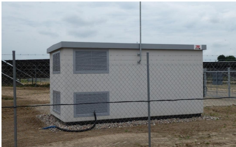
Fotografia 3 Stacja transformatorowa kontenerowa (źródło: zdjęcie własne)
