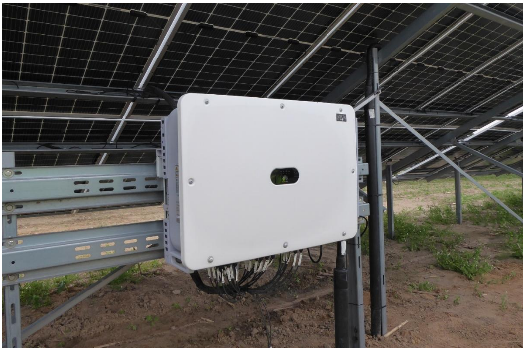
Fotografia 2 Przykład inwertera rozproszonego zamontowanego pod panelami (źródło: zdjęcie własne)
