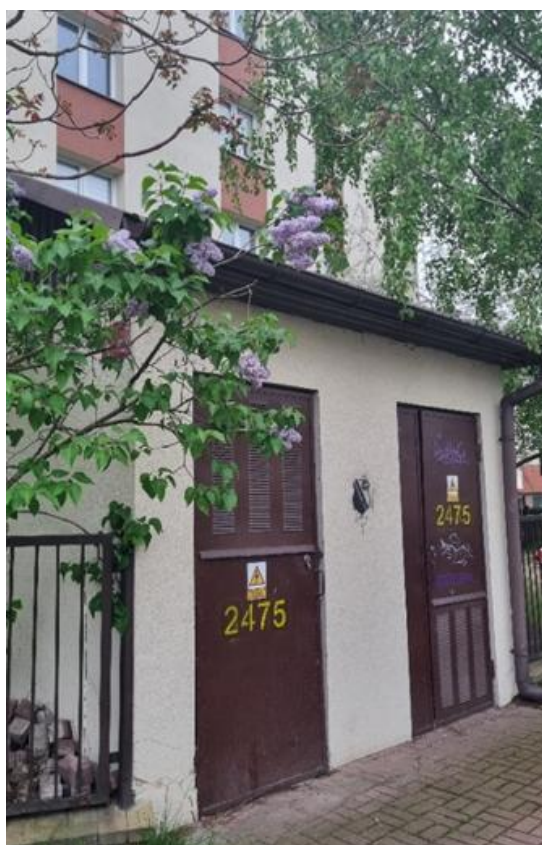
Fotografia 28 Stacja transformatorowa zlokalizowana 3 m od budynku wielorodzinnego (źródło: zdjęcie własne)
