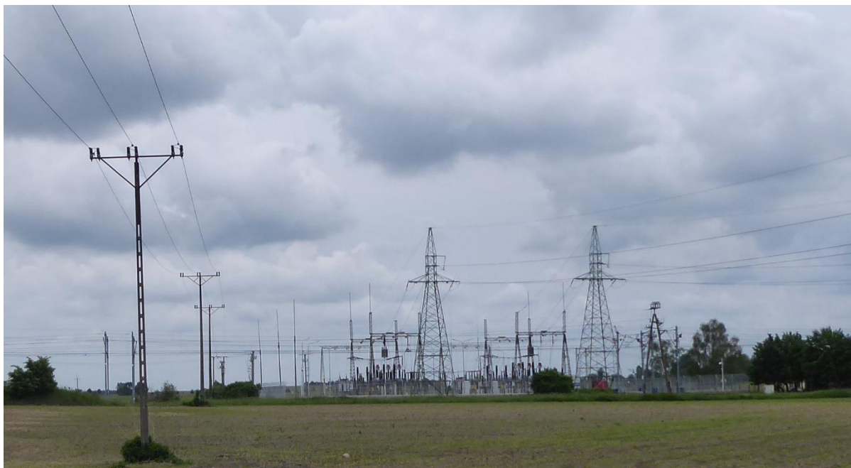
Fotografia 5 Przykładowy Główny punkt zasilający (źródło: zdjęcie własne)
