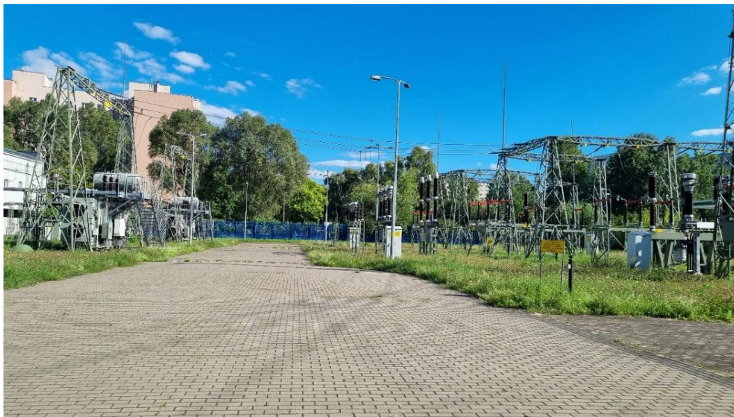
Fotografia 27 Stacja GPZ zlokalizowana 25 m od budynków wielorodzinnych (źródło: zdjęcie własne)
